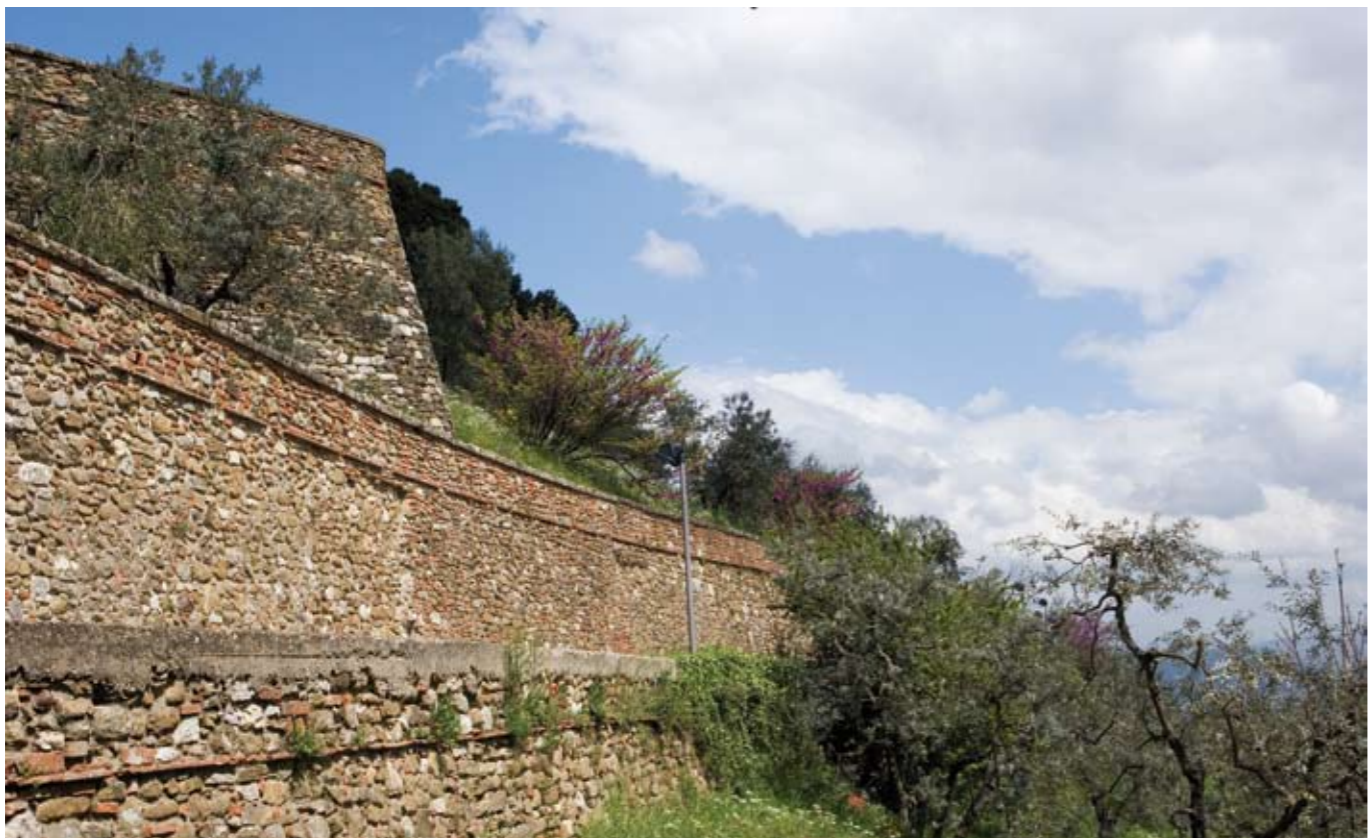
La cortina muraria utilizzava l'erto versante collinare (lato est) e ne seguiva l'andamento
